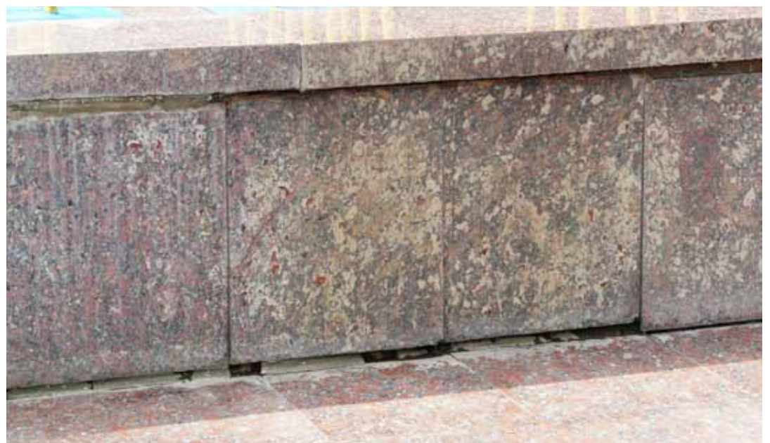
Рисунок 2. Комплексні пошкодження гранітного облицювання басейну (Чернігів): висоли, виділення іржі, селективне руйнування мінеральних компонентів, знебарвлення
