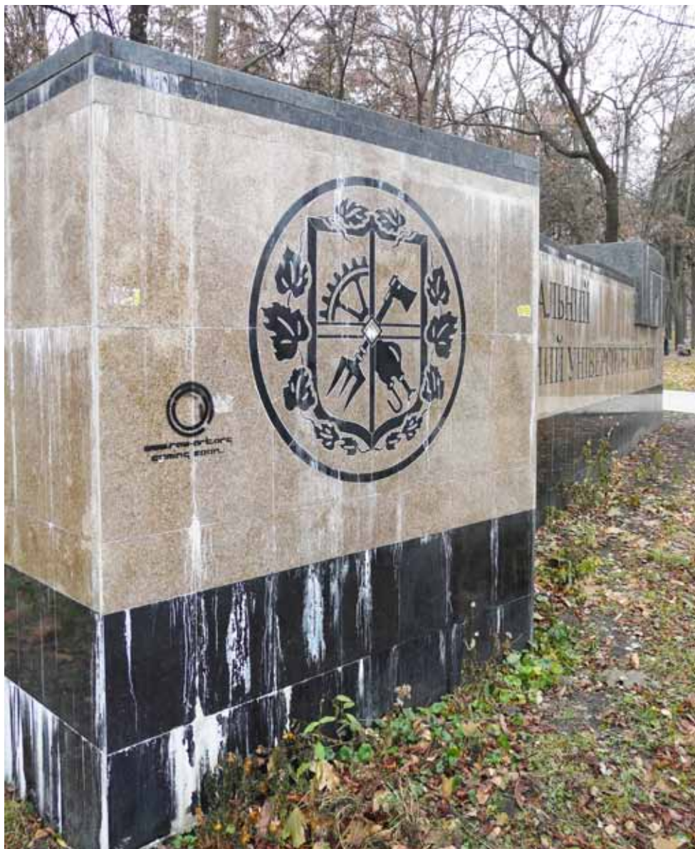
Рисунок 1. Комплексні пошкодження облицювання з граніту та габро (Київ): висоли, графіті, тріщини, зміна кольору
