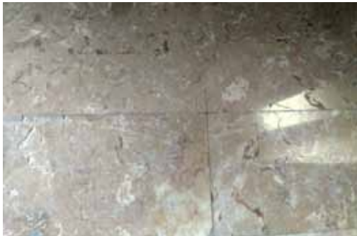
Дезінтеграція і руйнування поверхні облицювання з мармуру
