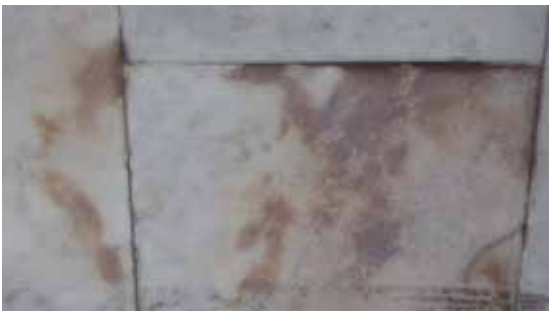
Виділення іржі на поверхні плити з мармуру
