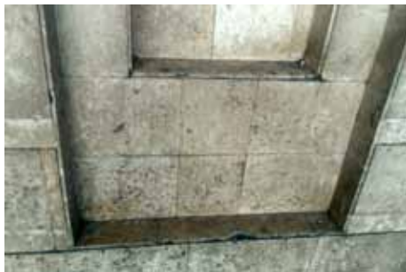
Забруднення відкладами сажі в облицюванні фасаду з вапняку
