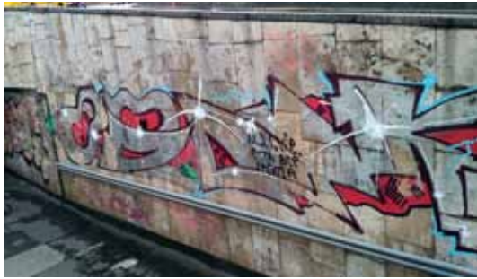
Комплексні пошкодження поверхні облицювання з травертину (втрати матеріалу, тріщини, зміна кольору, площинна ерозія поверхні, антропогенні забруднення, біогенні забруднення тощо)
