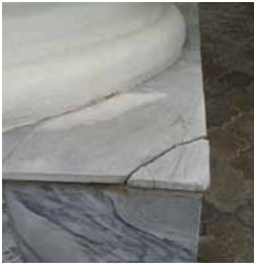
Тріщина на плиті з мармуру (базис колони)
