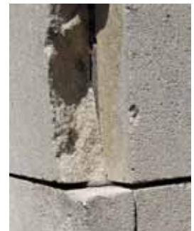
Вилущення вапняку (облицювальні плити)
