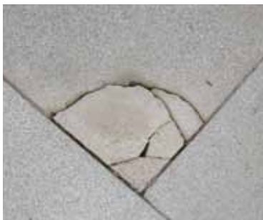
Руйнування вапняку (плити мощення)
