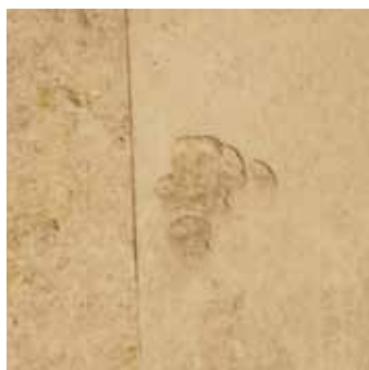
Вилущення вапняку (облицювальні плити)
