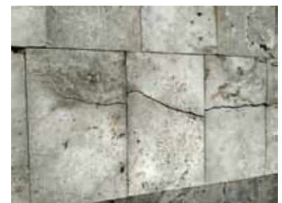
Тріщини на плитах з травертину (облицювання будівлі)
